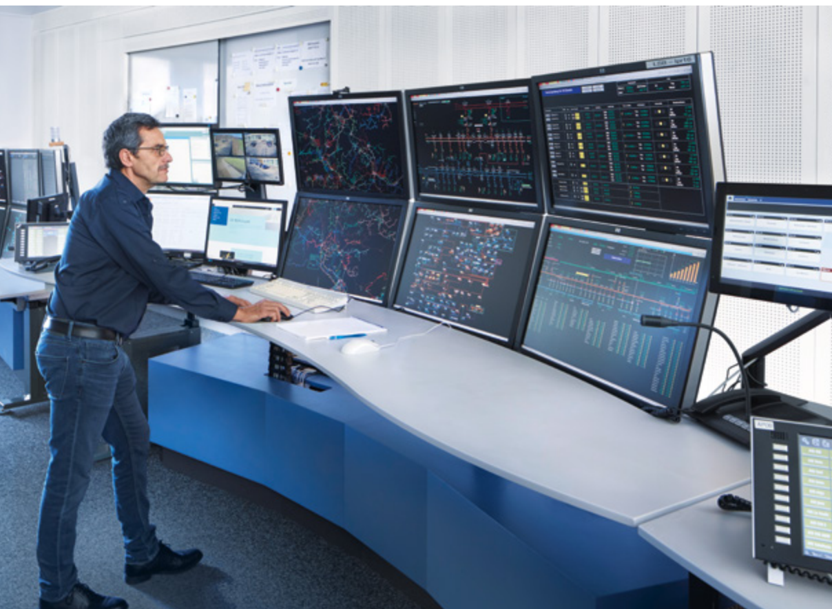
Überwachung der zentralen Leitstelle Mühleberg des Verteilnetzes der BKW.
