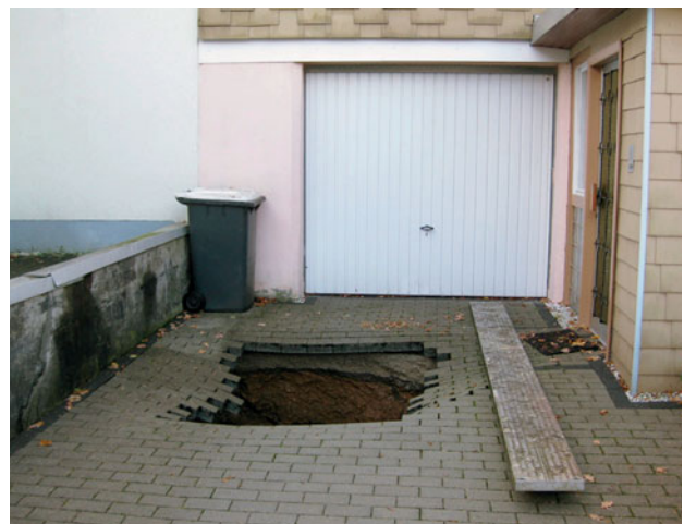
Tagesbruch auf „Alter Schacht“
