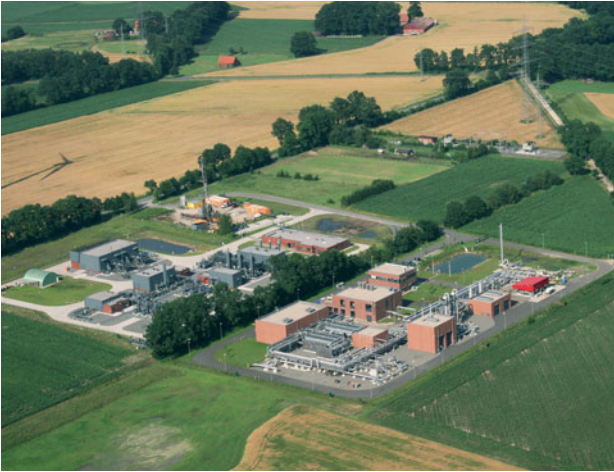
Verdichter- und Entnahmestationen in Epe
