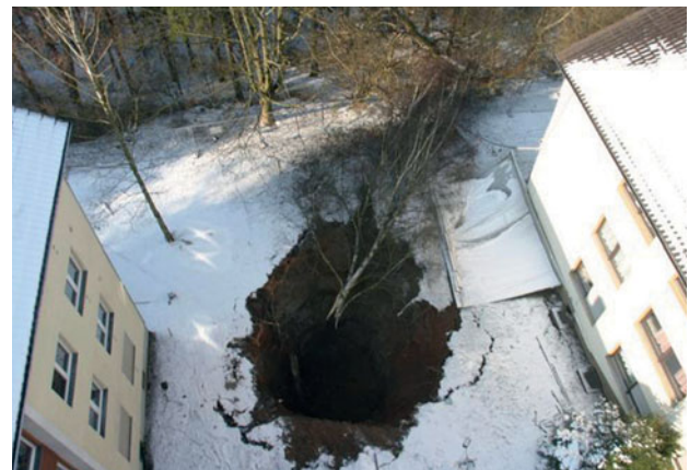
Tagesbruch in Siegen-Rosterberg
