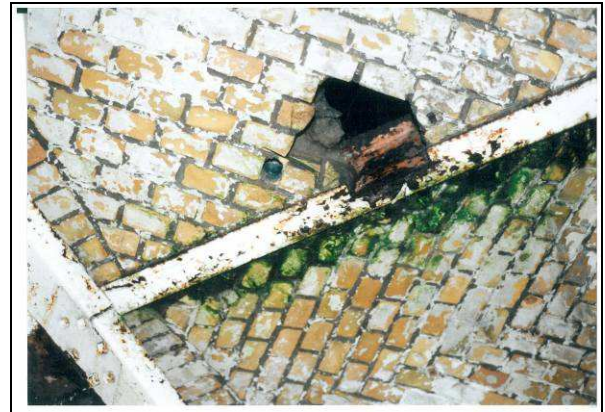
Bild 16: Schlachthof Offenbach, vergleiche Bild 1, Schweinestall; Kappendecke im Schwalbenschwanzverband nach 10-jährigem Leerstand d. Gebäudes
