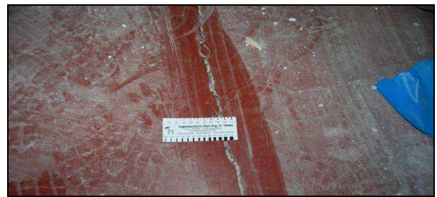
Bild 17: Spannungsrisse im Estrich
