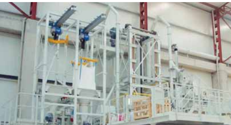
2 Big Bag Entleerstation in Batchbin Dosieranlage
