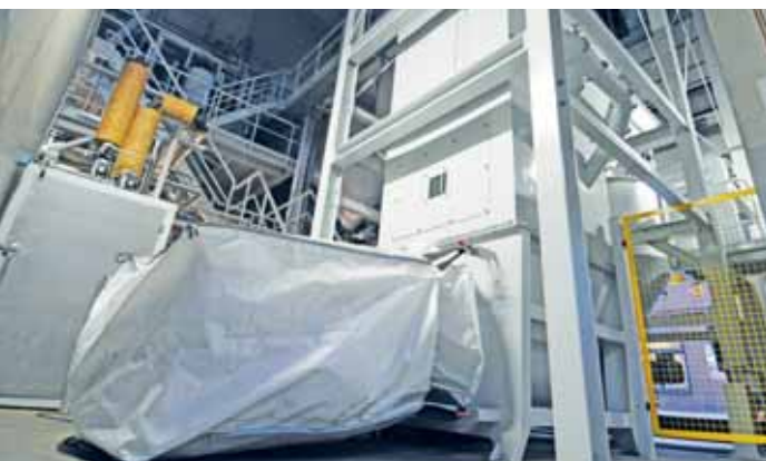
35 Big Bag Verdichter in automatischer Entleeranlage
