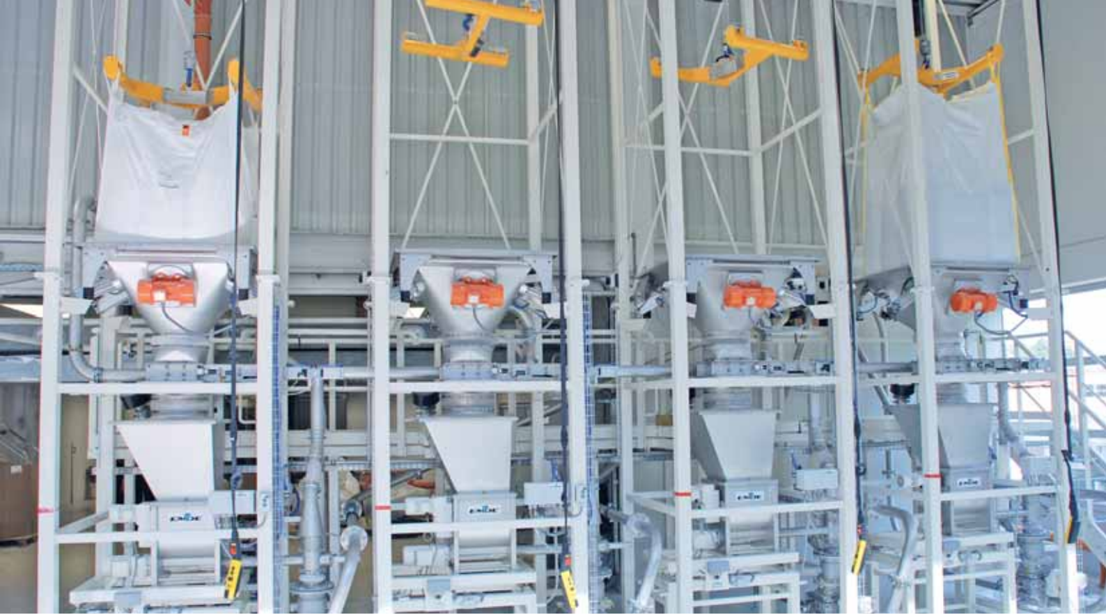
1 Big Bag Entleerstationen zur Beschickung von Differenzial-Dosierwaagen
