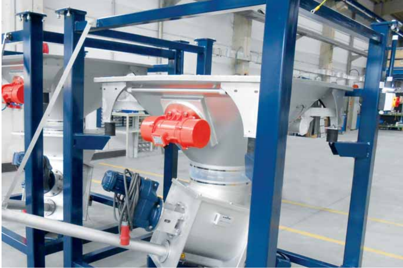
20 Big Bag Entleerstationen mit Vibrations-Austragsboden und nachgeschalteter Dosierschnecke
