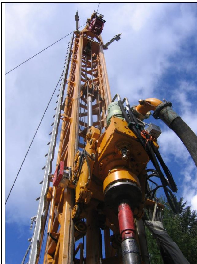
Rotary Bohranlage RB 40 mit Schnellläufer-Kraftdrehkopf für Seilkernrohr CSK 146 am Semmering in Österreich.
