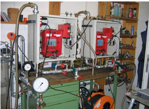
Druck-/Mengenmessgeräte Injektlim/Lugeonlim 4G im Dauertest
