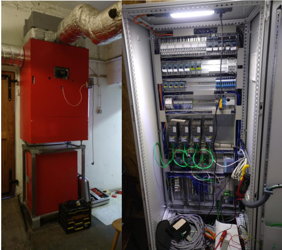
Abbildung 6: Installierter ESP und Installation der SPS
