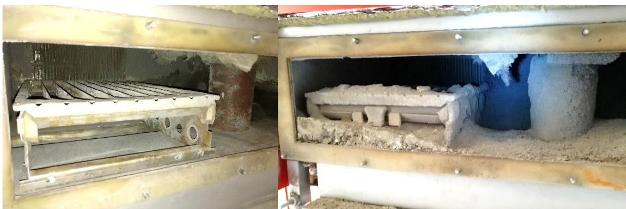
Abbildung 52: Leitblech im Staubbunker des ESP an der Kessel-Feldanlage und weiterhin ein Abscheiderrohr abgedeckt
