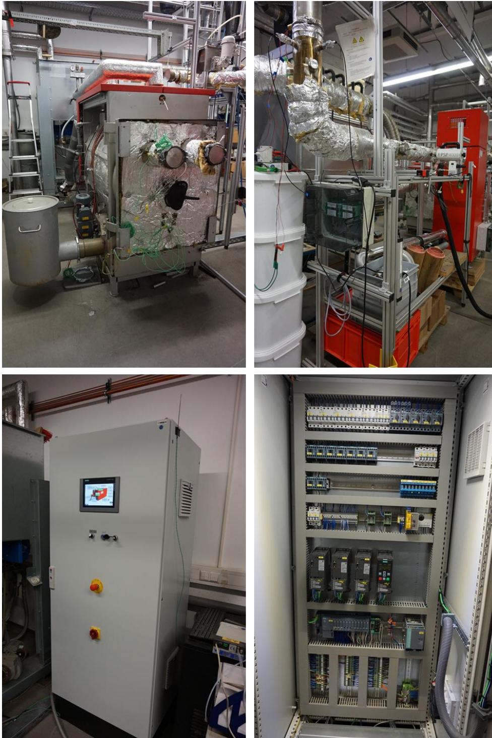
Abbildung 11: Aufbau der Versuchsanlage auf dem Prüfstand am DBFZ; oben links: Multifuelkessel Ökotherm mit 49 kW Nennleistung; oben rechts: Elektroabscheider mit nachgeschalteter Messstrecke und CO/HC-Sensoren; unten SPS
