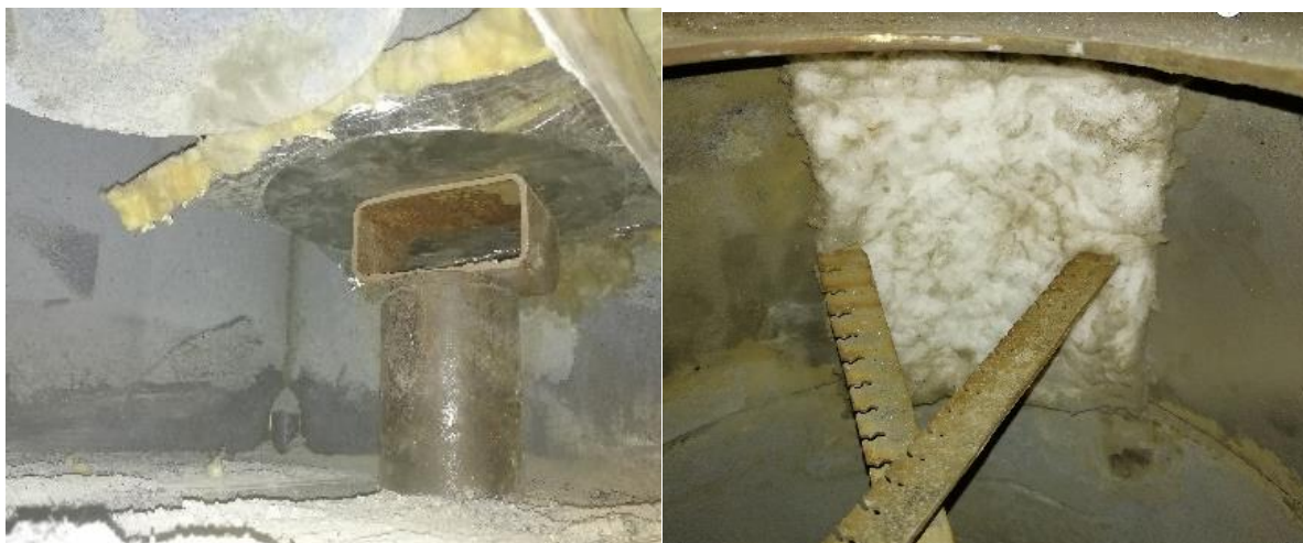
Abbildung 50: Blick in den unteren Bereich des ESP, ein Abscheiderrohr von unten abgedeckt und der Luftkanal von oben abgedichtet
