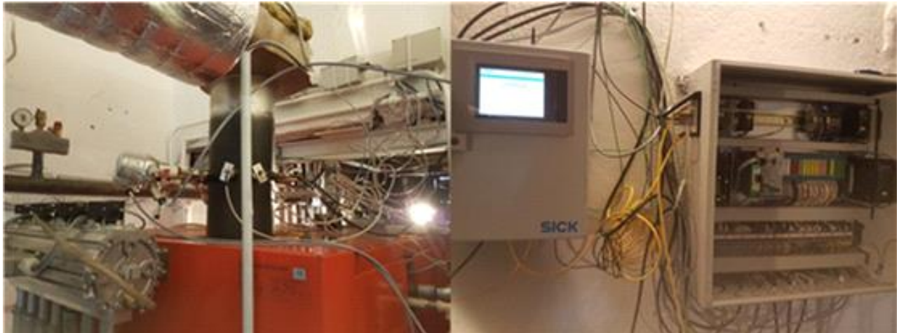
Abbildung 8: Monitor und Sensoren an der Feldtest-Hackschnitzelanlage der Firma A.P. Bioenergietechnik in Hirschau. Links: Abgassensorik mit Verkabelung. Rechts: Feuerungsprozessmonitor Sick AG
