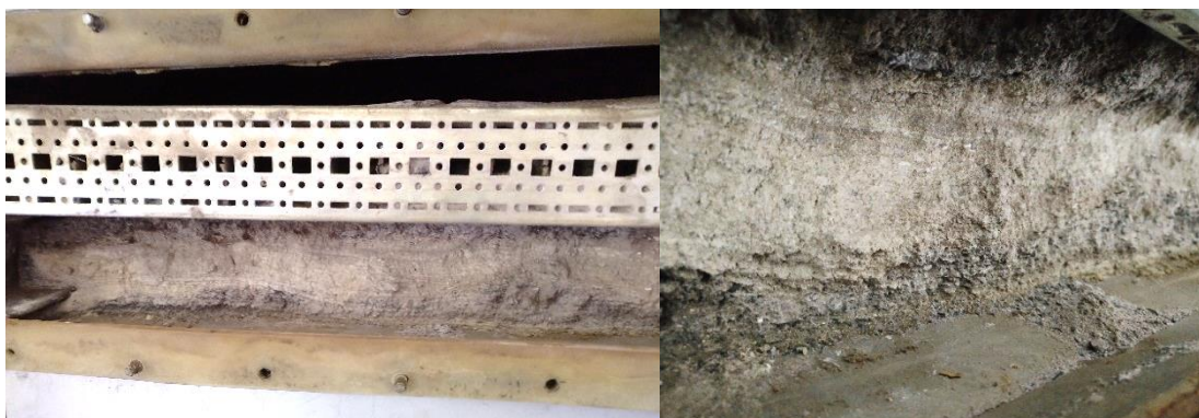
Abbildung 58: Schichtweise Ablagerung in der Beruhigungszone des Staubbunkers
