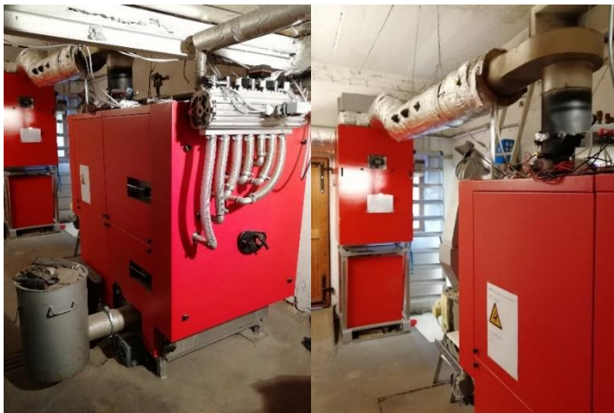
Abbildung 39: ÖKOTHERM®-Feldanlage und Abgasmesstrecke vor dem ESP
