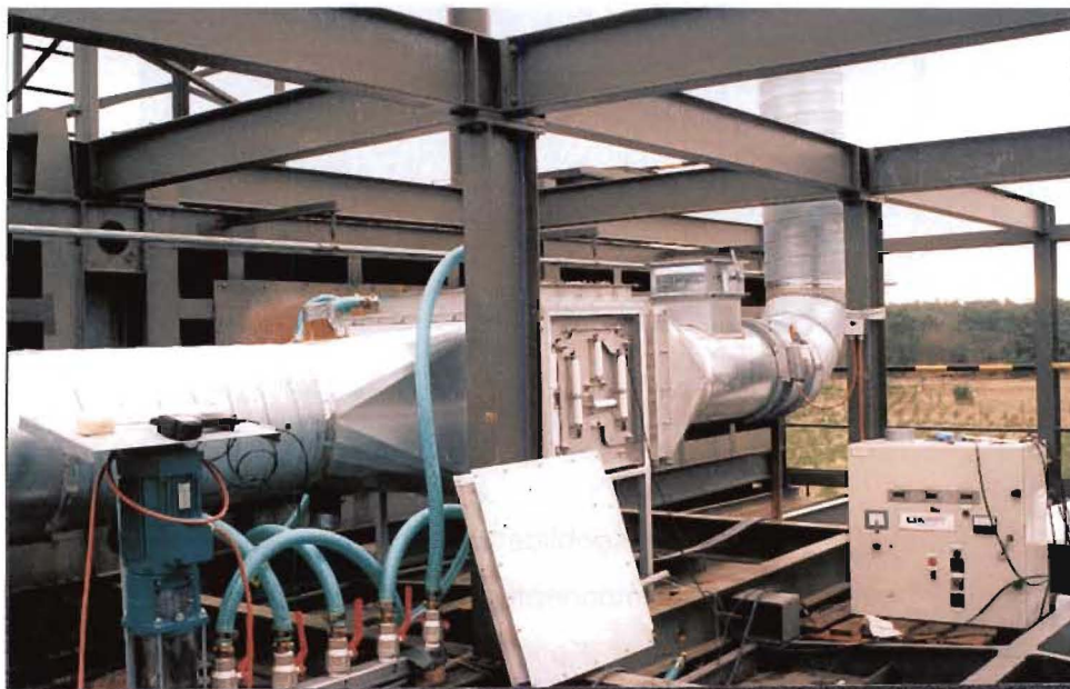
Abb. 3.3: Ansicht der Filteranlage auf der Brandsektion Schiff, WTD 91, Meppen
