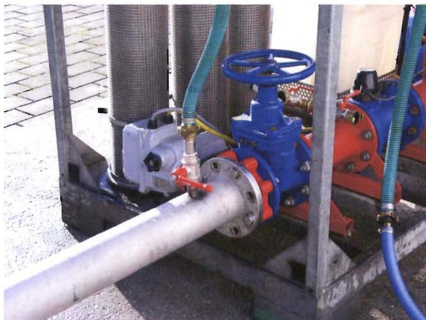
Abbildung 4-8: Dosierstelle von OXIDAT (nach dem Filter)
