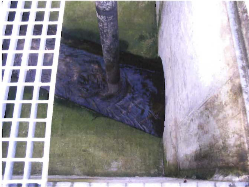
Abbildung 4-5: Entnahmestelle für das zu desinfizierende Abwasser
