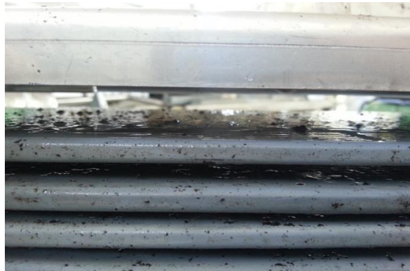
Abbildung 36: Sichtbarer Belag auf den Platten der Ultrafiltration
