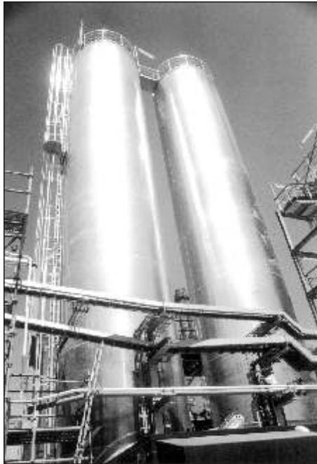
Bild 31 Zwischensilos in der neuen Polystyrolanlage
