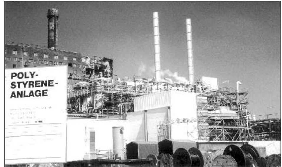
Bild 29 Neue Polystyrolanlage im Bau, im Hintergrund das alte Kraftwerk I 75 während der Demontage
