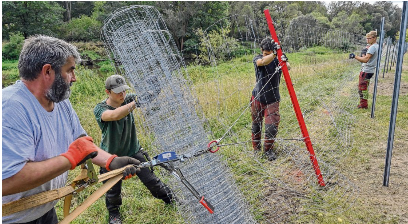
Mitarbeiter des Landesbetriebes Forst Brandenburg errichteten Ende September nahe dem deutsch-polnischen Grenzfluss Neiße einen festen Zaun gegen die Afrikanische Schweinepest. Die Uckermark wird in den nächsten Wochen nachziehen. FOTO: PATRICK PLEUL/DPA
