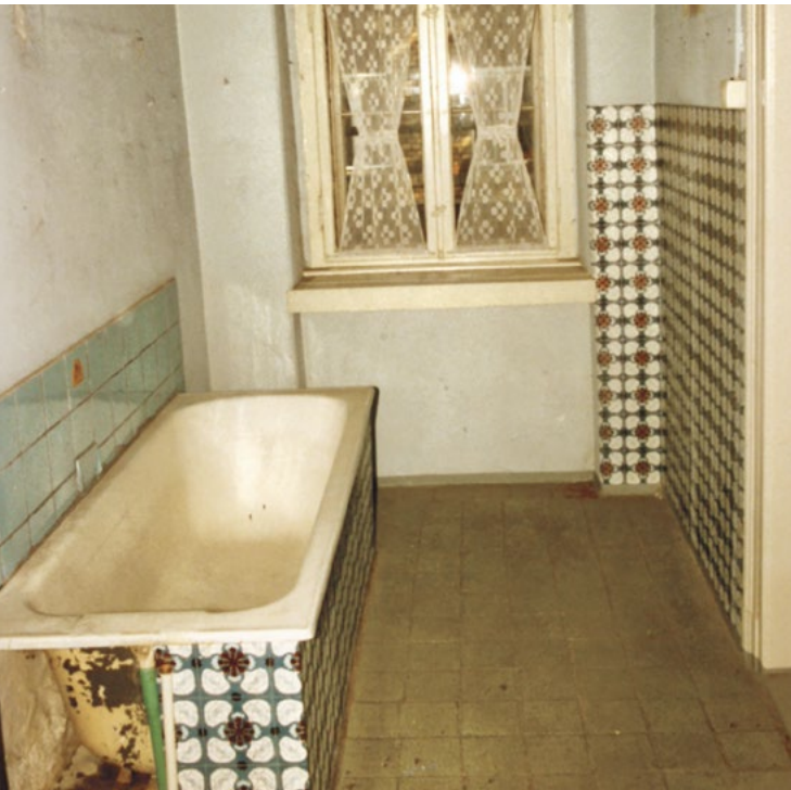
Abgewohntes Bad in der Poststraße 22, Aufnahme von 1994
