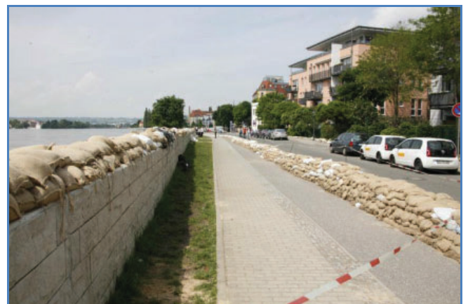
Bild 9.8: Fachlich nicht sinnvolle Sandsackverbaue an der Kötzschenbroder Straße (Quelle Brand- und Katastrophenschutzamt der Landeshauptstadt Dresden)
