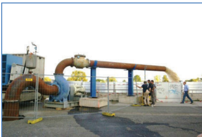
Bild 8.1: Prov. Hochwasserpumpwerk Böcklinstraße am 5. Juni 2013
