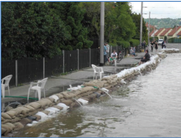
Bild 9.5: Sandsackverbau entlang der Leubener Straße zum Schutz der linksseitigen Villacher Siedlung (Quelle: Umweltamt der Landeshauptstadt Dresden)
