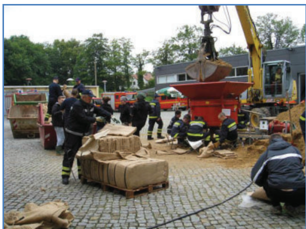
Bild 9.9.1: Sandsackabfüllplatz Lockwitz am Dienstag, dem 04 Juni 2013 (Quelle: BKSA der Landeshauptstadt Dresden). Abfüllen der Sandsäcke durch Feuerwehrleute mit Hilfe technischer Geräte.
