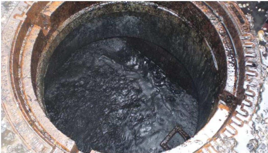
Ausspeisung in Kanal
