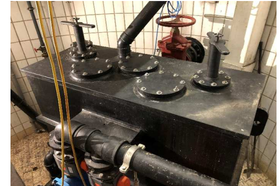
Strate-Pumpwerk mit Rechen
