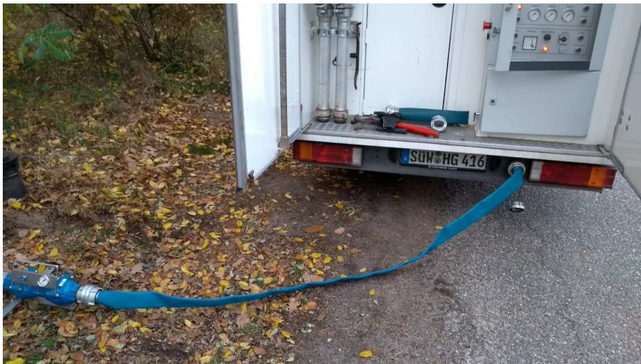
Druckluft-Einspeisung mit Comprex®-Einheit
