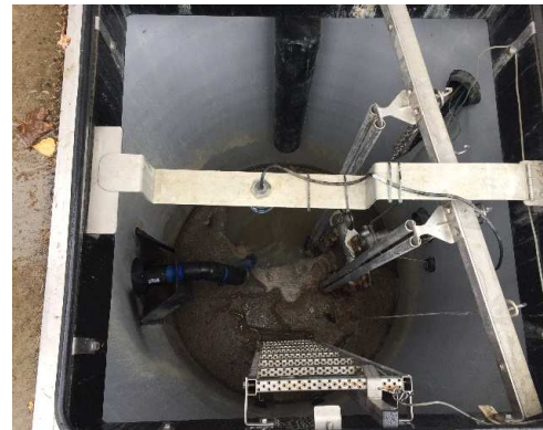
Schachtpumpwerk mit Tauchpumpen
