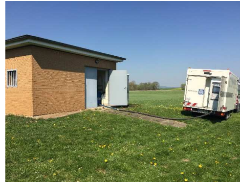
Pumpstation mit trocken aufgestellten Pumpen
