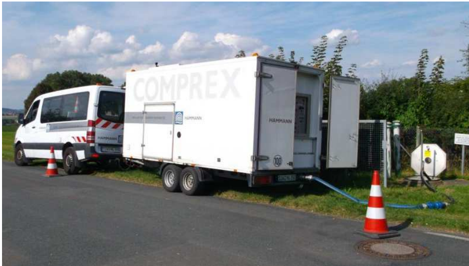
Druckluft-Einspeisung mit Comprex ® -Einheit
