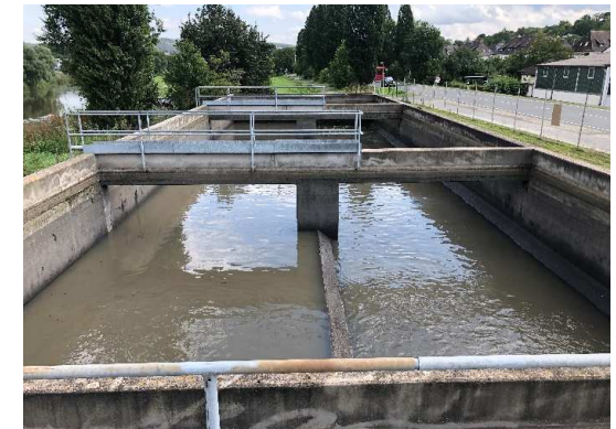
RÜB als „Wasservorrat“ nutzbar
