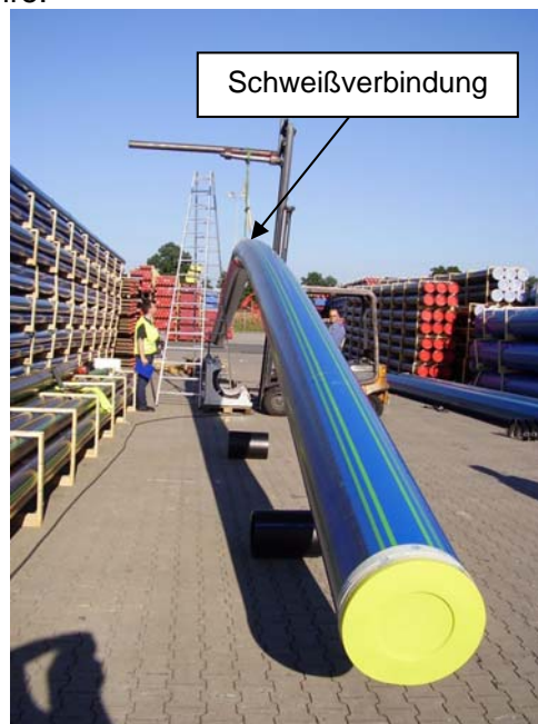
Bild 6: Mechanische Belastung der Schweißverbindung, Quelle: Hessel Ingenieurtechnik
