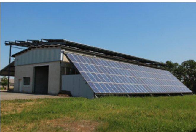
Abbildung 2 - Unsere Photovoltaikanlage am Standort Wenigenauma
