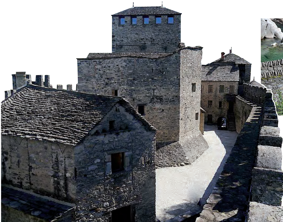
Die Dächer des Castello di Montebello in Bellinzona bestehen aus Gneis. Das ist eines der drei mittelalterlichen Schlösser der Stadt, die Teil des UNESCO-Weltkulturerbes sind.
