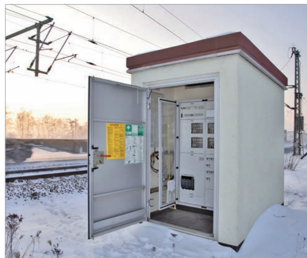
Fertigteilstation BS 180 mit eingebauter Weichenheizungsverteilung
