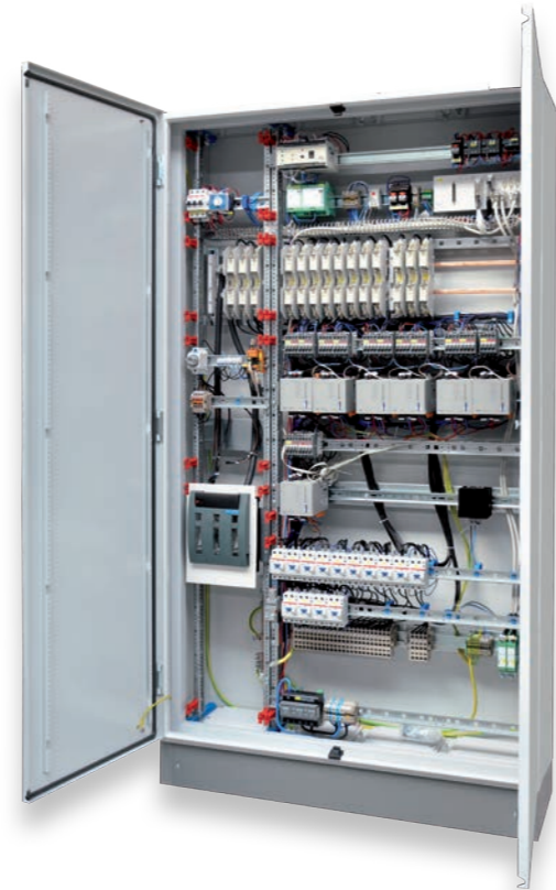
Beispiel: Verteilung mit leistungselektronischen Schaltgeräten ISR25-4, Innenraumaufstellung (Darstellung ohne Abdeckung und der darin integrierten Bedien- und Anzeigeeinheit BEA) Ausführung in Schutzklasse I (geerdet) da Versorgung aus 16,7 Hz-Netz
