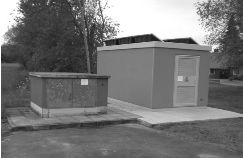
Abb. 6.3: Außenansicht von alter (links) und neuer Ortsnetzstation (rechts, mit SRONT)
