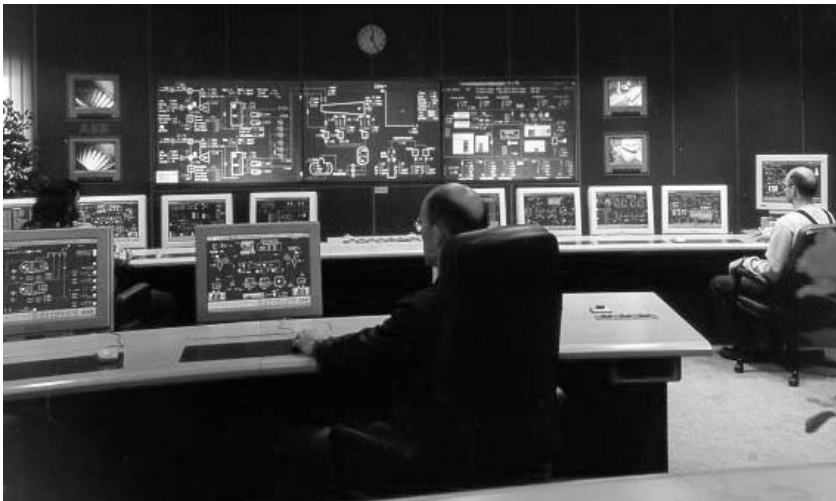
Abb. 6: Moderne Leitwarte eines Kraftwerks, Ausschnitt (Abdruck mit freundl. Gen. von ABB-Deutschland)
