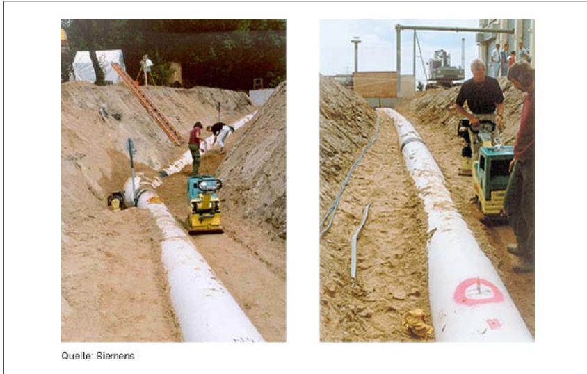
Abb. 6.9: Erdverlegung gasisolierter Rohrleiter (GIL)
