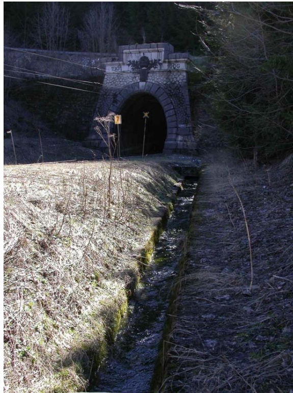
Abbildung 24: Bosphuck – Tunnel – Wassermenge am Nordportal
