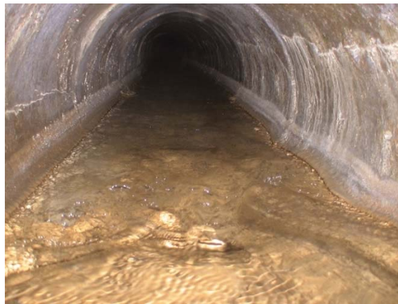
Abbildung 28: Zentrale Ableitung unter dem Gleiskörper des Karawankentunnels
