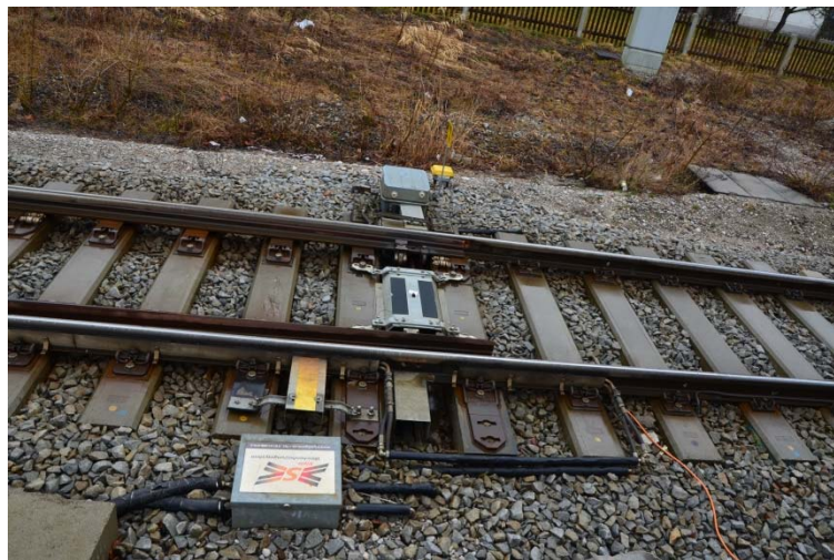
Abbildung 58: Weiche 2 mit Wärmezuleitungen
