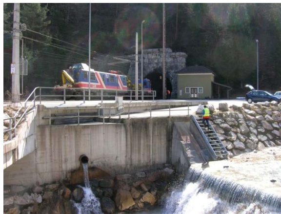
Abbildung 29: Einleitung des Tunnelwassers des Karawanken-Eisenbahntunnels
