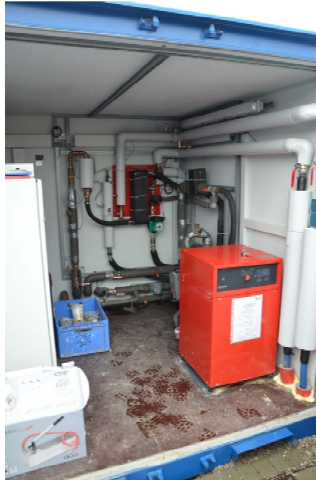
Abbildung 57: Container mit Wärmepumpe und Regelungseinheit
