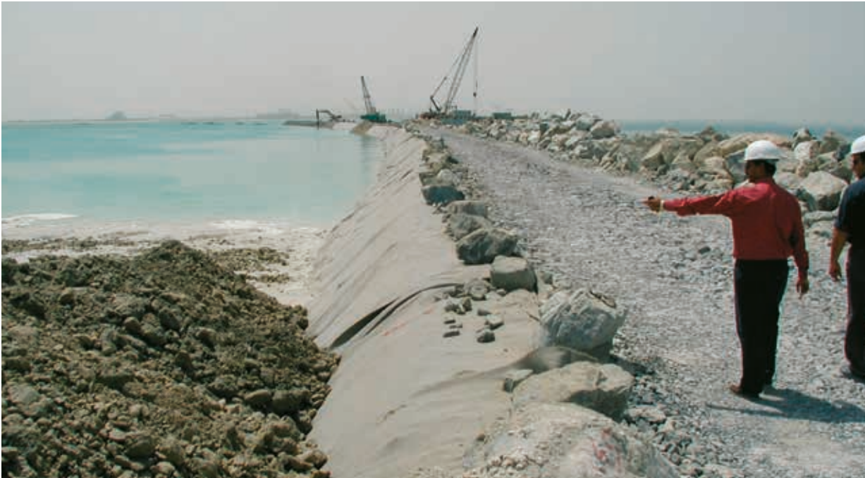
Palm Island, Dubai. Installation von Fibertex F-650M. Das Fibertex Geotextil wird komplett mit groben Gestein, Kies und Sand abgedeckt.
