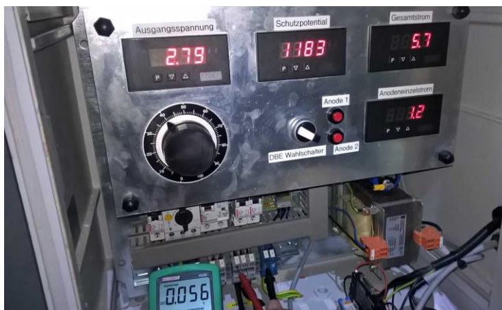
Abbildung 23: Fremdstromanlage auf FINO3
