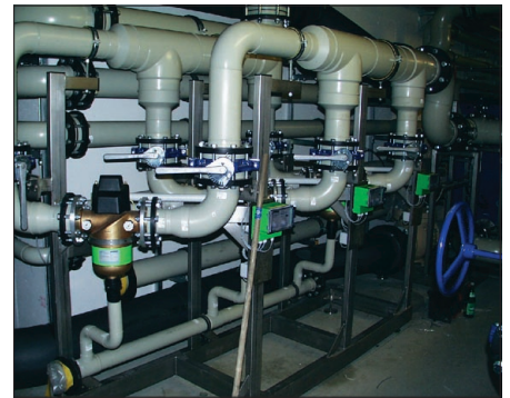
Bild 2: Rohrleitungssystem aus PP
