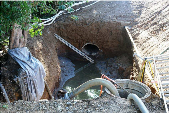
Baustellenansicht: Erosion deutlich erkennbar - Wände instabil
