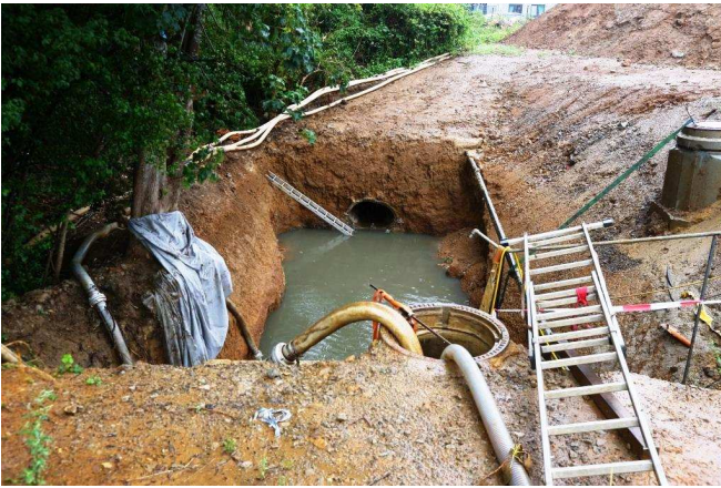
Baustellenansicht nach einem Starkregenereignis
