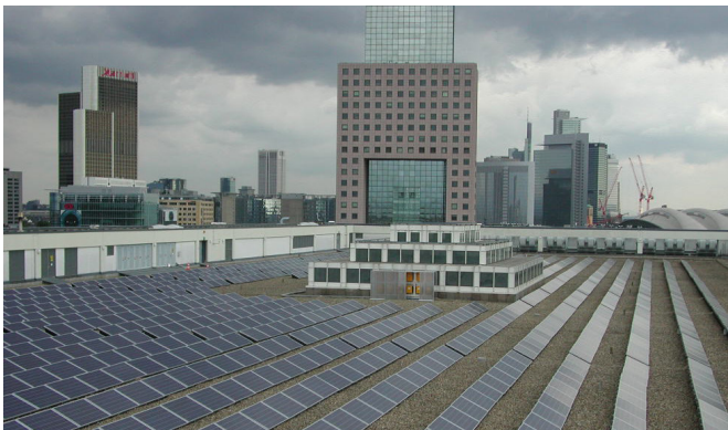
Abb. 3: Photovoltaikanlage Messe (Quelle: Energierreferat FFM)
