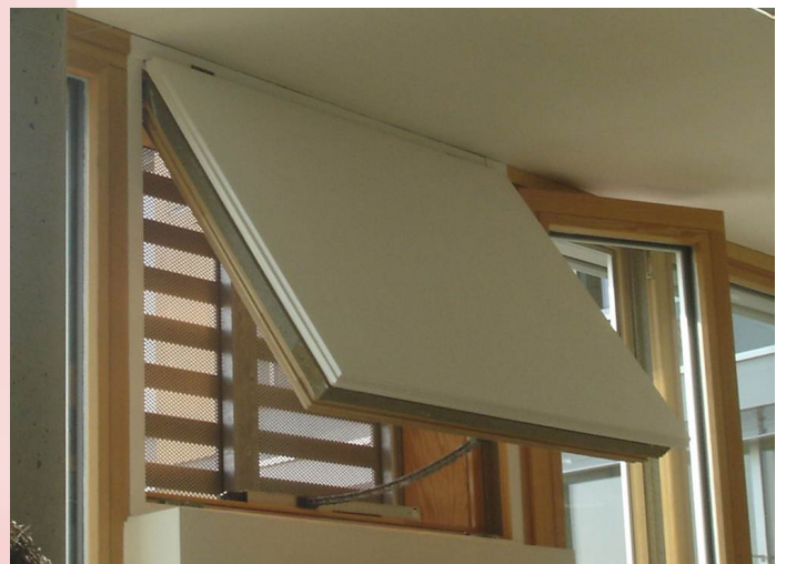
Abb. 5: Nachtluftklappe (Quelle: Hochbauamt FFM)
