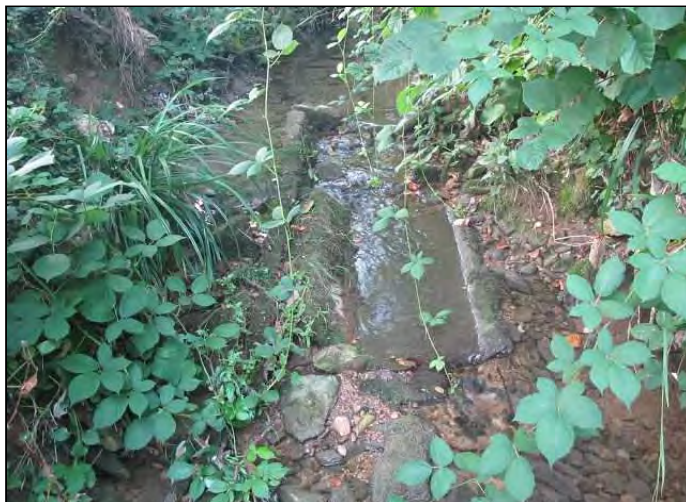
Abb. 5: Nicht mehr funktionelle Ufer- bzw. Sohlenverbauungen
