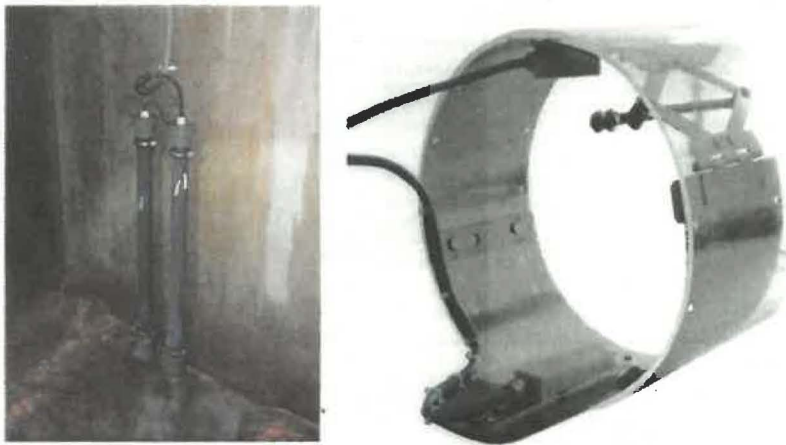
Abb.6 : Einbausituation Mess-Sensorik und Rohrmontagesystem (Fa. Nivus) für die Durchflussmessungen
