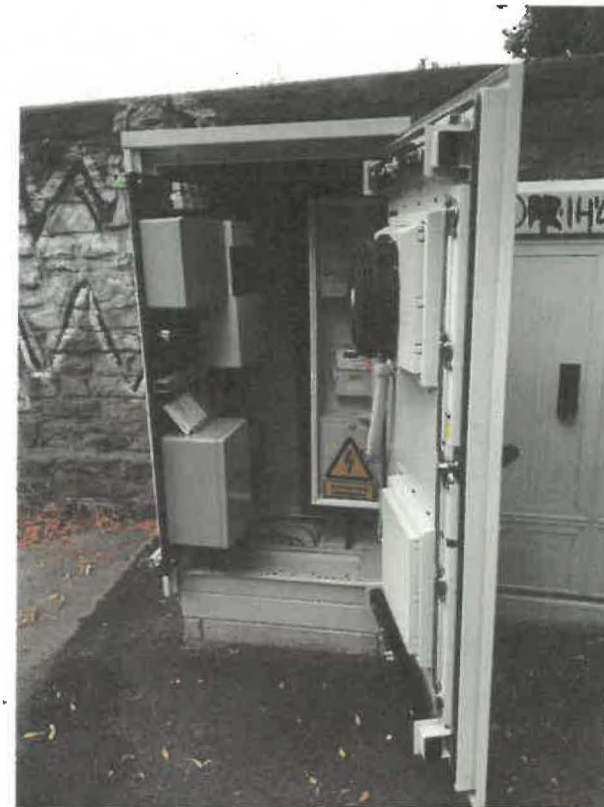
Abb.7: Schaltschrank mit Datenerfassung
