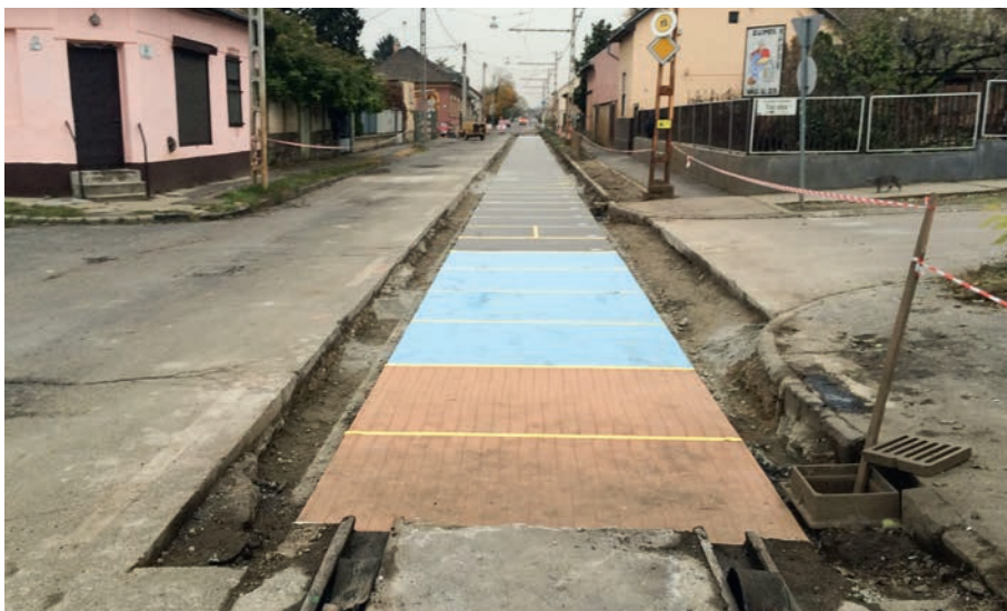
Abb. 2: Übergangsbereich mit Sylomer-Matten
