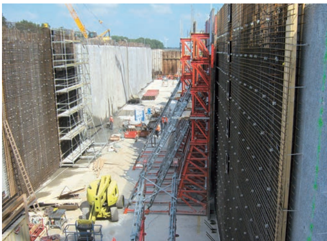
Bild 12 Bewehrung, Schalung und Betonage der Vorsatzschale Reinforcement, formwork and concreting of facing
