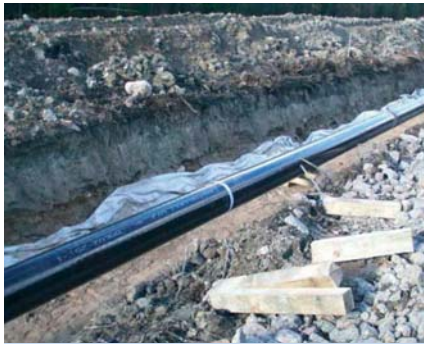
Bild 9. Erdgaspipeline mit Polymerbeschichtung.
