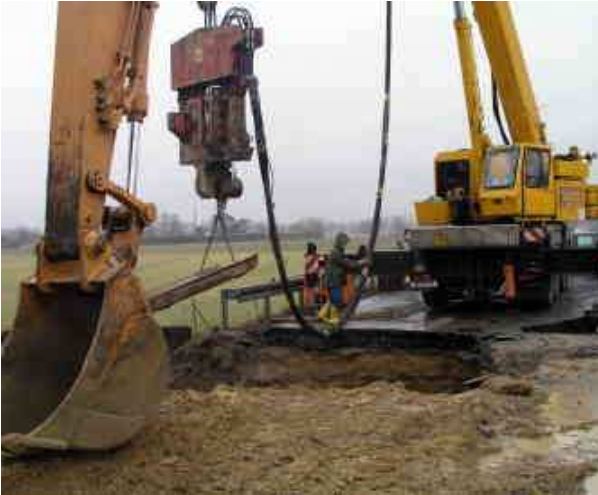
Loch in der Autobahn: Ein ausgespülter Bachdurchlauf stoppte gestern die Autofahrer auf der A93 zwischen Schwarzenfeld und Schwandorf. Foto: Fröschl
