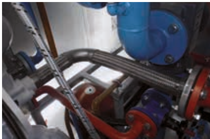
Edelstahlwellschlauch in einem Blockheizkraftwerk mit 90°-Bogen mit einerseits Losflansch und Anschweißende andererseits
