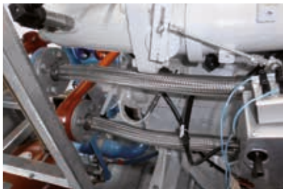
Edelstahlwellschlauch in einem Blockheizkraftwerk mit Losflanschen
