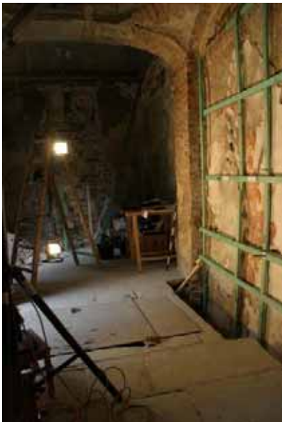
Abb. 5 Görlitz, Nikolaifriedhof, Wandmalerei in der Jakobigruft mit Erwärmung durch Halogenstrahler
