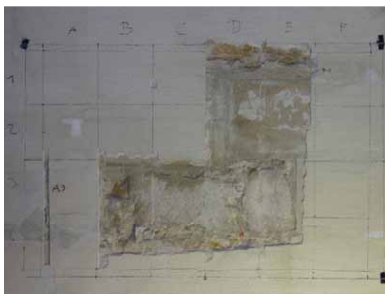
Abb. 158 Versuchswand nach Abnahme der losen Putzschollen zur Vermessung
