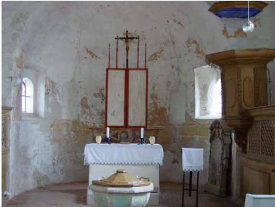
Abb. 160 Dorfkirche Battaune, Apsis mit teilweise freigelegter romanischer Wandmalerei
