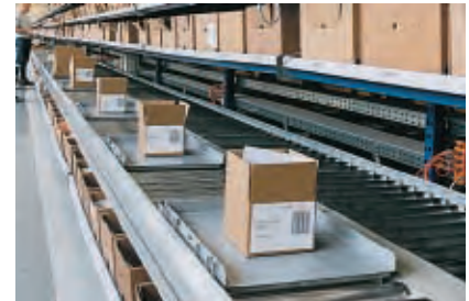
Im ifm-Logistikzentrum Essen sind sämtliche Sensoren im Fördersystem per AS-i mit der übergeordneten Steuerung verbunden.
