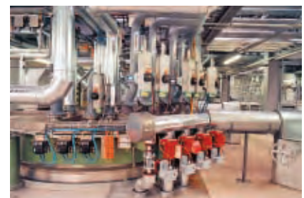
Bei der Deutschen Shell AG im Werk Grasbrook wurden weit über 2.000 Schwenkantriebe über AS-Interface vernetzt.
