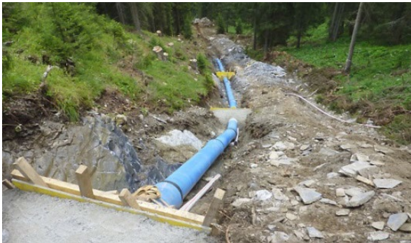
Abb. 19: Druckrohrleitung des 1.8 MW Kraftwerks Tambobach, Splügen, in Betrieb seit 2012 [49]
