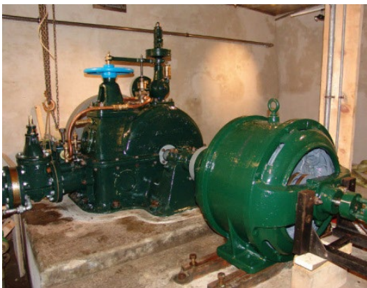
Abb. 10: Historische Turbinenanlage, Baujahr 1899 [19]
