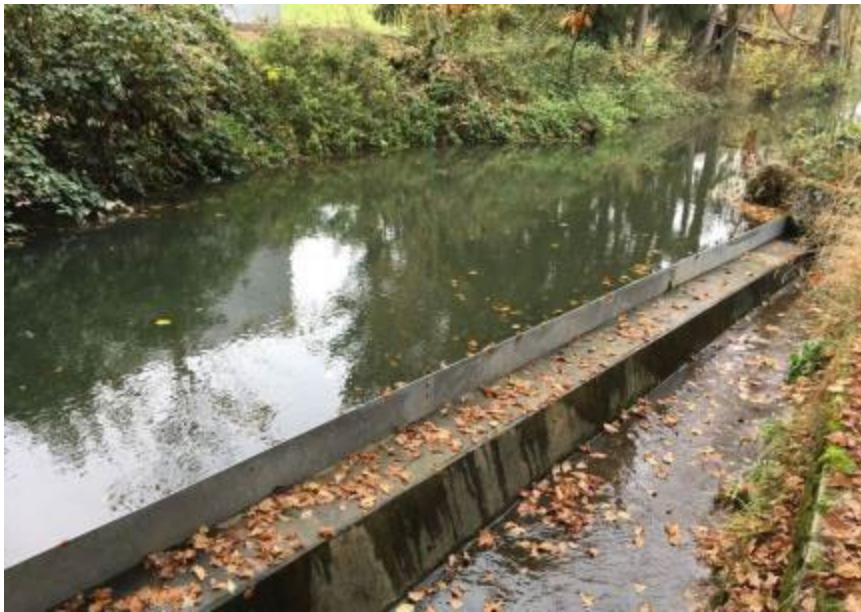
Abbildung 2-7 Streichwehr zur Abflussregulierung
