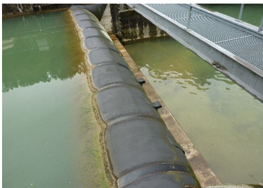
Abbildung 2-6 Schlauchwehr KW Juramill, Laufen (Birs)
