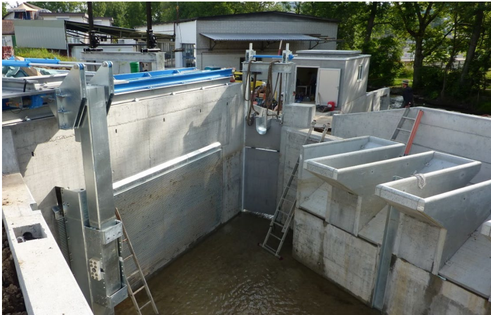
Abbildung 2-8 Horizontalrechen (links im Bild) beim KW Hämmerli
