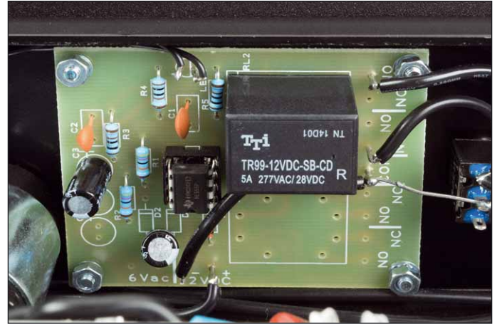
Auf eine Platine darf nur die Einschaltverzögerung
