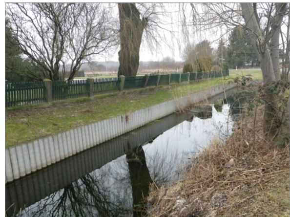
Abbildung 4-5: Keine Übergangszone linksseitig vorhanden
