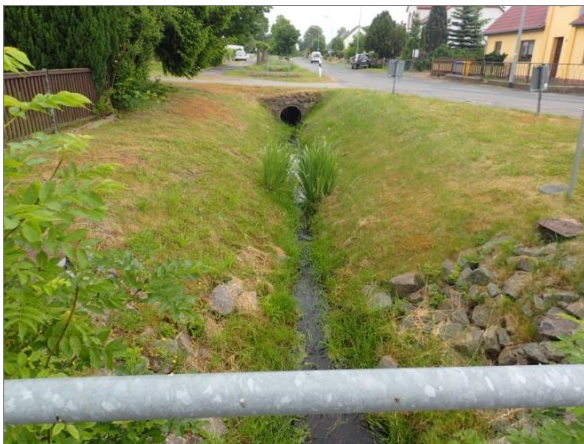
Abbildung 4-4: Übergangszone halbdurchgehend vorhanden
