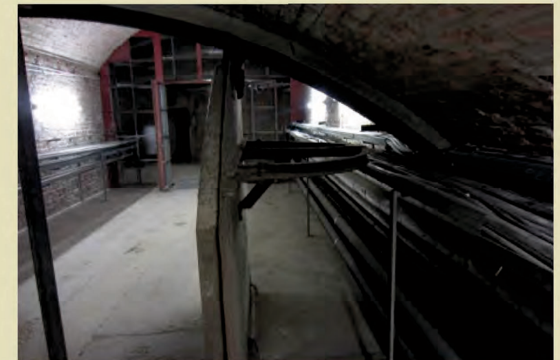
Historische Drehtür zur Steuerung der Luftmengen
