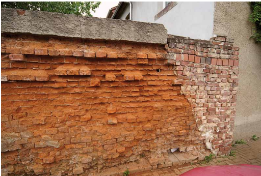
Abb. 5: Massiver und überstehender Mauerkopf; Ausbeulen und Schiefstellung der Mauer
