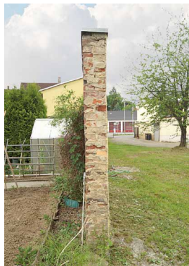
Abb. 3: Mauerdicke 0,24 m; zu geringer Überstand der Abdeckung auf der Wandkrone; beidseitig freie Windangriffsfläche
