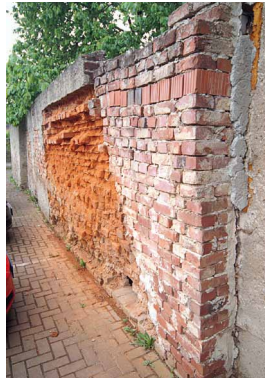
Abb. 6: Abriss und Neigung der Mauer in Richtung der öffentlichen Parkplätze
