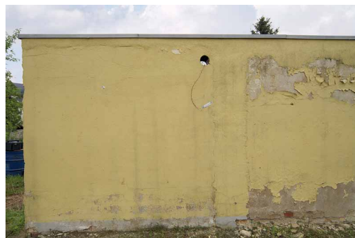
Abb. 4: Risse im Putz zeichnen den »Mauerwerksverband« nach; großflächige Anstrich- und Putzablösungen am Mauersockel; Erdreich liegt am Mauersockel an
