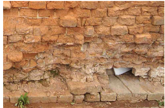
Abb. 7: Korrosion bis zur halben Mauerdicke; loser Mauerwerksverband am Mauersockel
