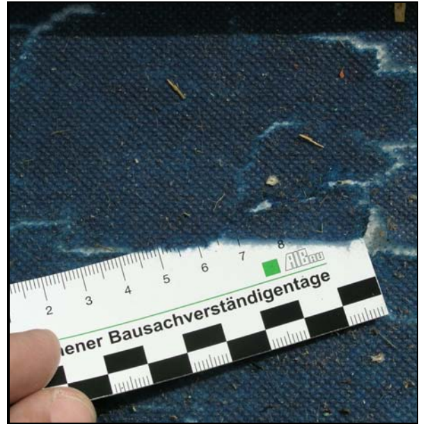
Abb. 34: Delamination der Unterspannbahn
