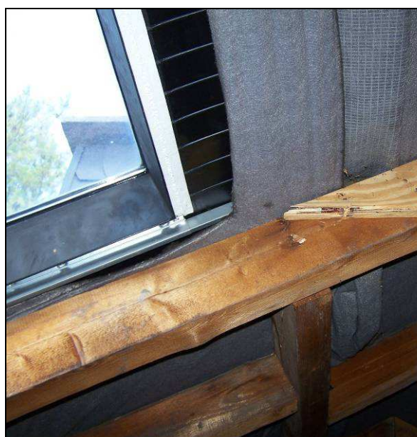
Abb. 56: ... auch am Anschluss an das Dachflächenfenster.
