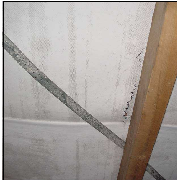
Abb. 28: Riss entlang eines Sparrens
