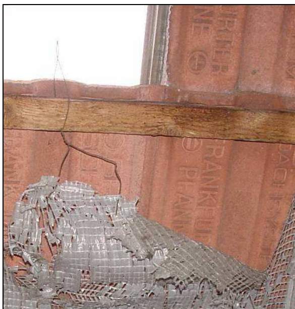
Abb. 57: Vollständig zerstörte gitterverstärkte Folie
