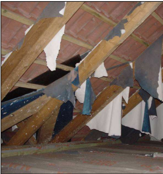
Abb. 27: Großflächig zerstörte Unterspannbahn
