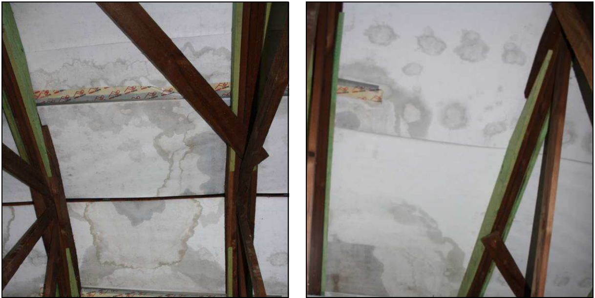
Abb. 49 und 50: Zahlreiche Wasserdurchtritte durch die Unterspannbahn im Bereich des Regelquerschnittes und entlang der Fugen der Eindeckungselemente
