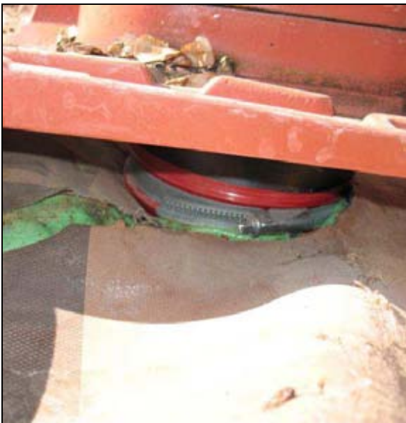
Abb. 53: Offener Anschluss zwischen Unterspannbahn und Rohrdurchführung
