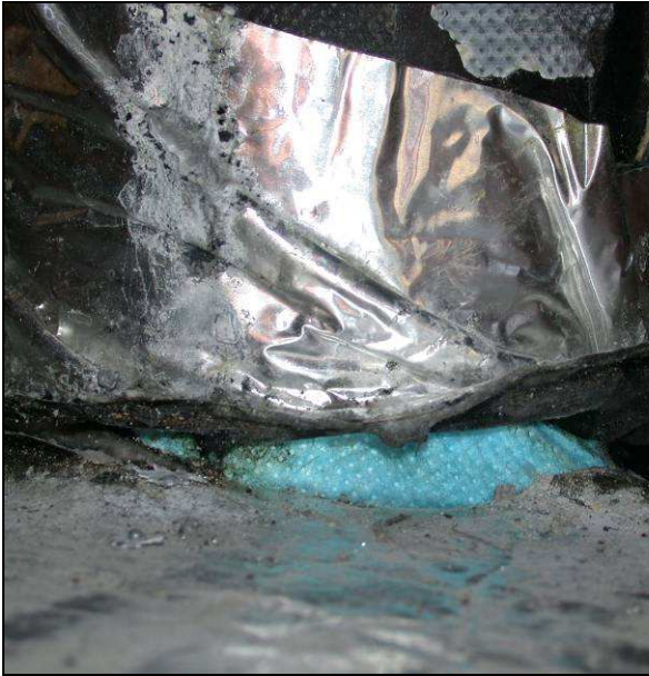
Abb. 51: Risse in der Butylbandmanschette der Rohrdurchführung
