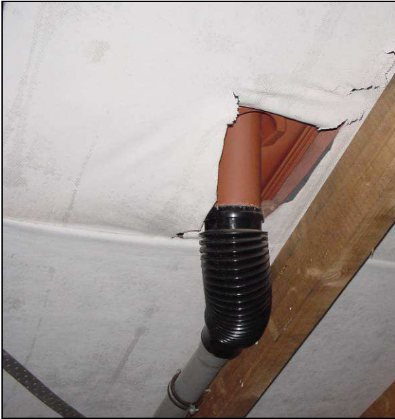
Abb. 29: Nicht an die Unterspanbahn angeschlossene Rohrdurchführung
