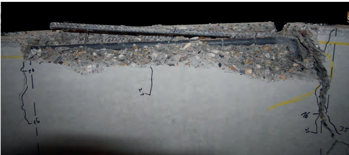
Bild 4.13: Balken nach Versagen und Ablösen der Betondeckung über Riss-Nr. 2a und 2b (a) Draufsicht; (b) Seitenansicht
