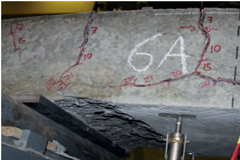
Bild 3.5: Versagen durch Biegedruckbruch infolge Stahlfließens (Balken R6)
