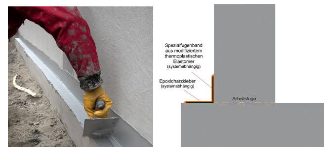
Abb. 14: Abdichtung der Arbeitsfuge mit einem vollflächig, mit einem starren Epoxidharzkleber aufgeklebten streifenförmigen Fugenabdichtungsband
