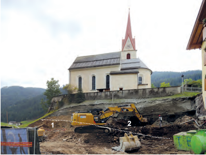
Abb. 124 - Aushub im Norden des Hügels der Kirche St. Andreas, mit dem Felsuntergrund aus quarzreichen Glimmerschiefern (1) und darüber bzw. rechts (2) unterschiedlich großen Blöcken aus überwiegend Kalksilikatmarmoren. Bichl, Ratschingstal.
