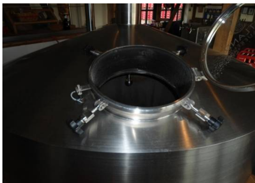
Abbildung 104: Probenahmeort Würzepfanne (Brauerei)
