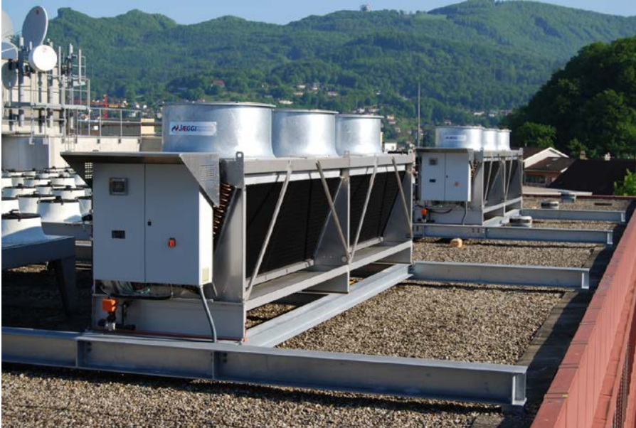
Abbildung 7: Hybridkühler für die Klimatisierung von Rechner- und Serverräumen einer Telekommfirma
