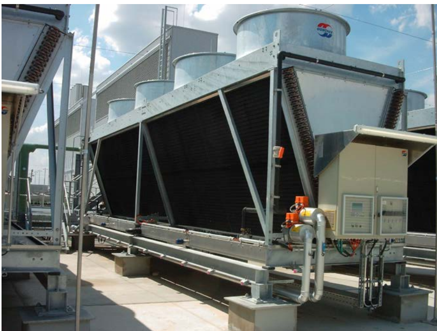
Abbildung 6: Hybridkühler für ein Rechenzentrum bei SAP
