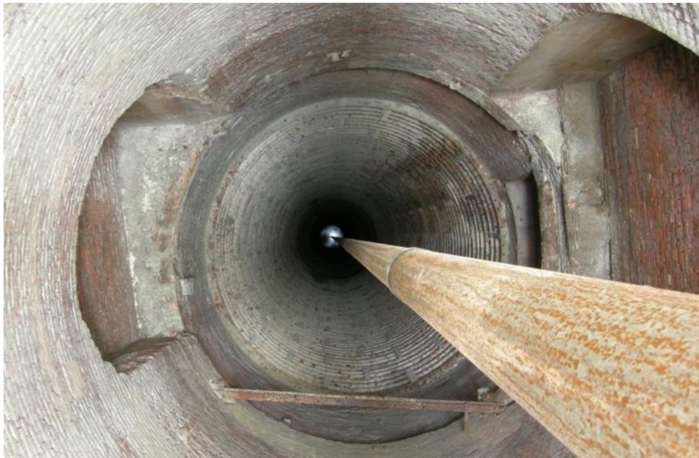
Abb.3 : Eingehangene und abgespannte Führungsrohrtour im oberen Schachtabschnitt, links und rechts im Bild sind die abgemauerten Schachtzugänge sichtbar.
