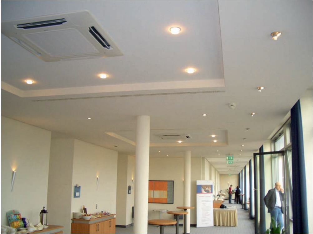
Abb. 7 Raumklimageräte in der Bauart als Deckenkassetten in einem Hotelflur mit Seminarräumen
