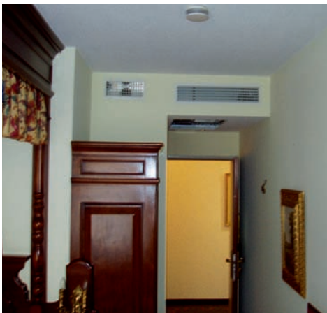
Abb. 8 In diesem Hotelzimmer befindet sich das Klimagerät hinter dem Zuluftgitter.
