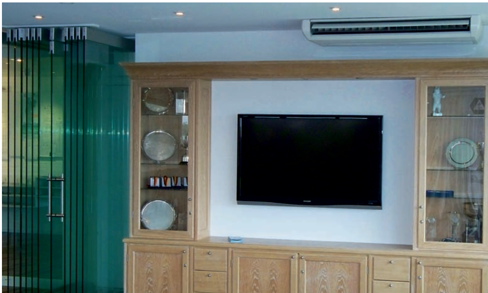
Abb. 6 Ein Raumklimagerät an der Decke
