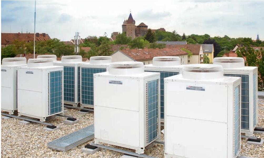
Abb. 3 Mehrere kompakte VRF-Module auf einem Gebäudedach. Die dargestellte Anlage hat eine Gesamt-Kälteleistung von mehr als 250 kW.
