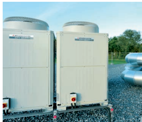
Abb. 1 Typische VRF-Module auf einem Gebäudedach
