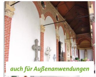
bei salzbelastetem Mauerwerk
