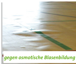
nicht abgedichtete Betonböden
