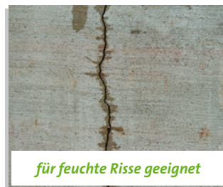
dringt in feinste Risse ein
