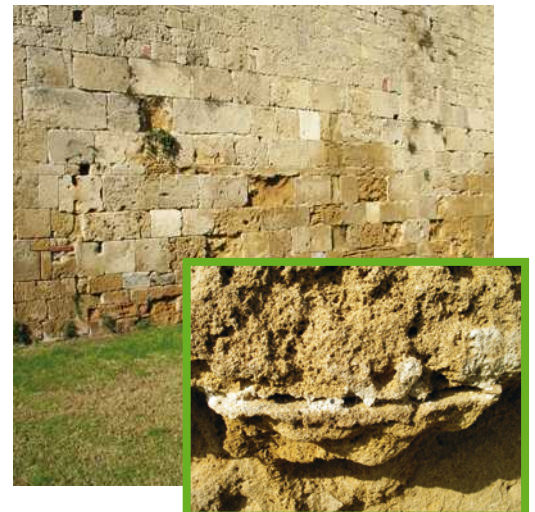
Salzscha den durch aufsteigende Feuchtigkeit
